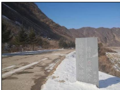
图 20 虎哨口岸-关门砬子段（K0+000~K11+632） 三级公路路基现状
